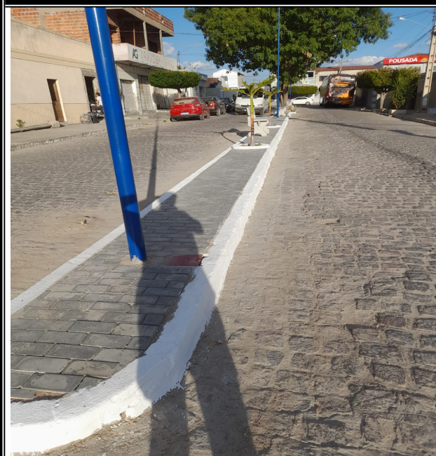
Foto 7: POSTES E PISO INTERTRAVADO.
