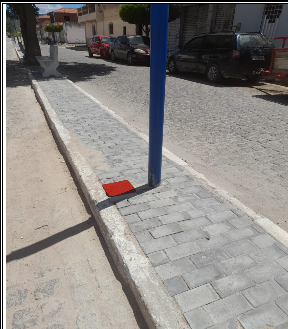
Foto 4: POSTES E CAIXA DE PASSAGEM.
